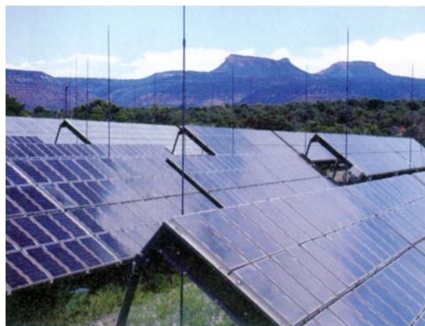
▲太陽能發電系統，將多個太陽電池串聯在一起，可產生更大的電壓。
